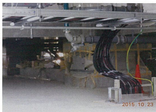
D棟・免震装置
